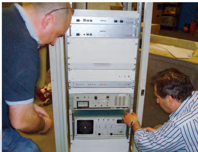
EA2BJM y EA2GRI trabajando en el rack
